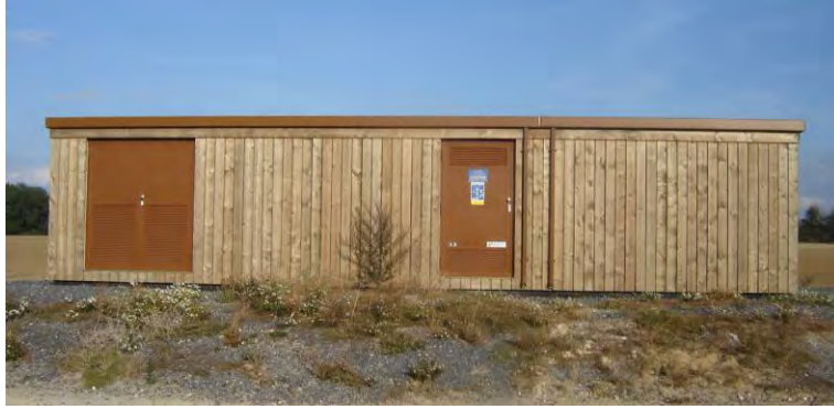
Implantation du poste de livraison et exemple de poste recouvert en bardage bois
